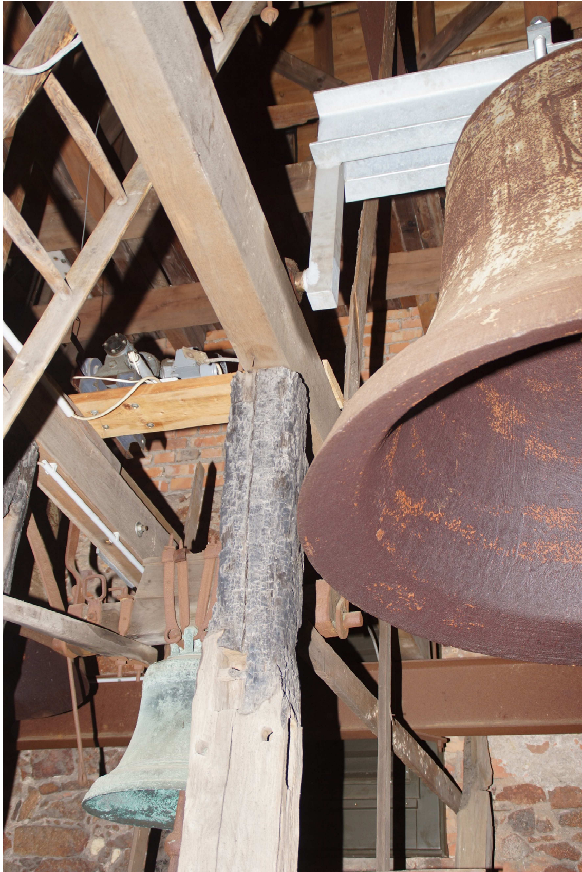
Der Blick auf verkohlte Stütze, Stahlkonstruktion, Metallglocke [Eisenhartguss EHG] (im Hintergrund die kleine 3e'' Bronzeglocke)
